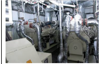
Salle des machines
